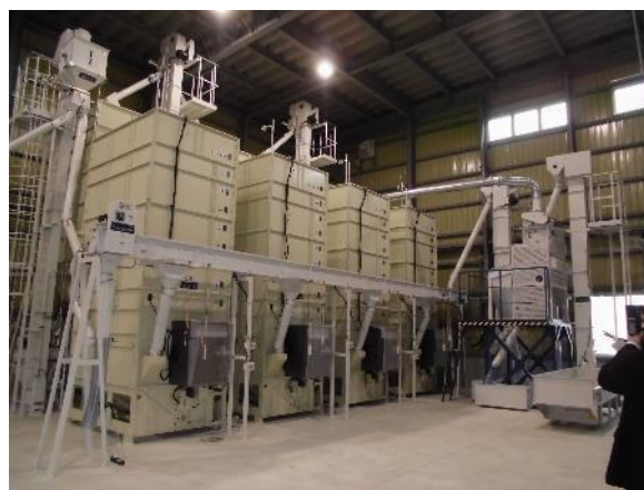
新設された乾燥調製施設内部の様子
