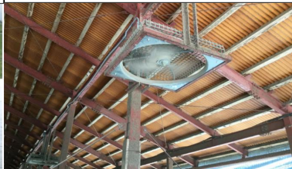
県内肥畜農家に設置されたファン
