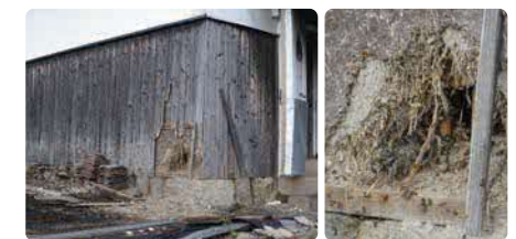
ハチの巣を狙って壊された建物
