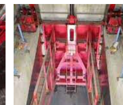
放流設備（コンジットゲート）
