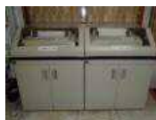
テレメータ放流警報設備
