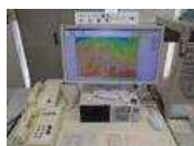
テレメータ放流警報設備
