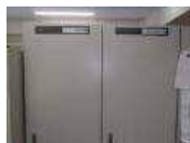
テレメータ放流警報設備
