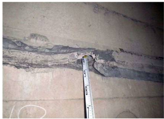
壁面打継部の剥離
