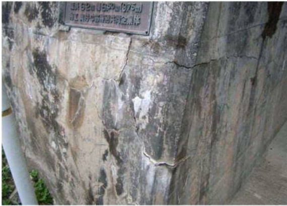
抗門面壁のひび割れ
