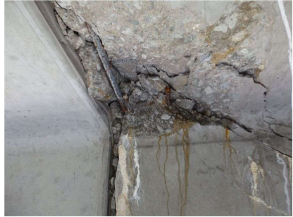
はく落を伴う鉄筋露出（頂版）
