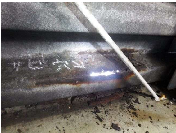
頂版の断面欠損
