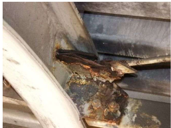
ガセットプレート部分の腐食
