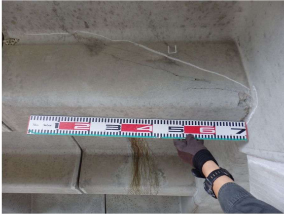
ひび割れ、はく離・はく落（横梁）
