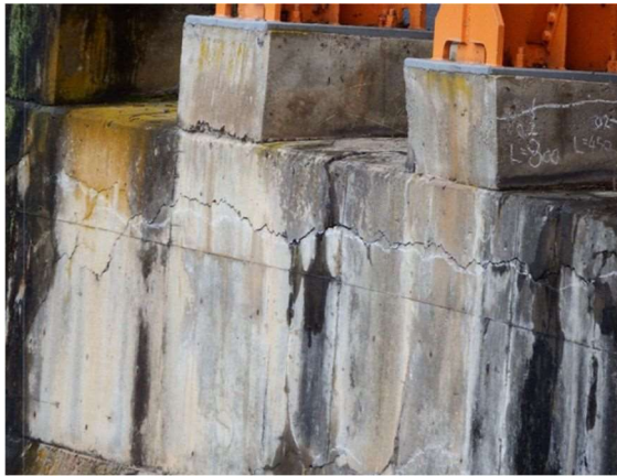
受台のひび割れ
