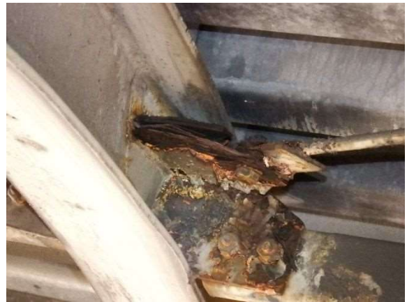
ガセットプレート部分の腐食
