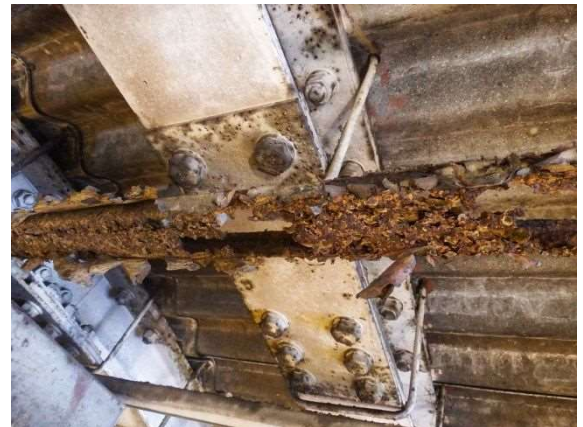
照明取付レールの断面欠損、破断
