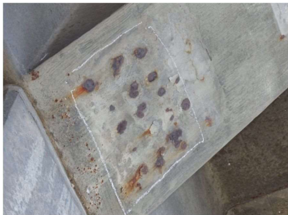
PC 鋼材からの錆汁（主梁）
