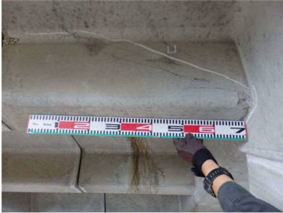
ひび割れ、はく離・はく落（横梁）
