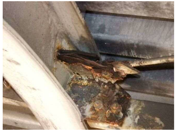
ガセットプレート部分の腐食
