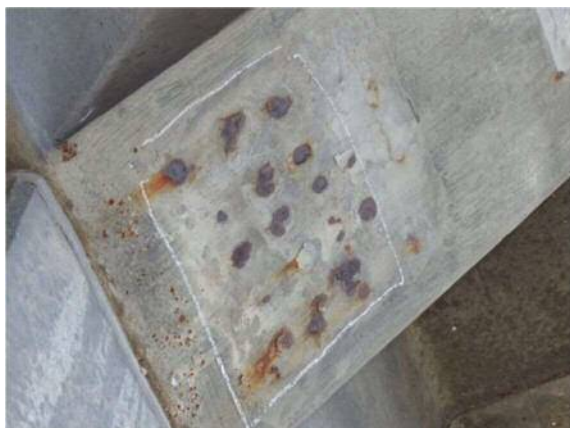
PC 鋼材からの錆汁（主梁）
