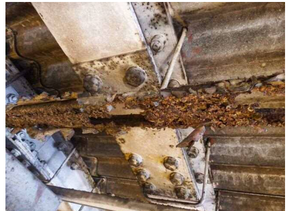
照明取付レールの断面欠損、破断
