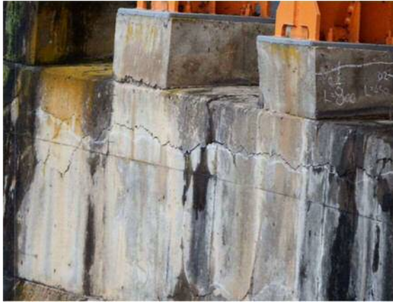
受台のひび割れ
