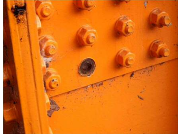
取付ボルト (F11T) の破断
