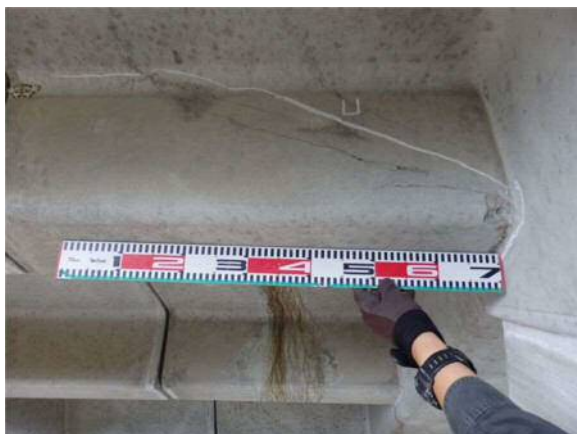
ひび割れ、はく離・はく落（横梁）
