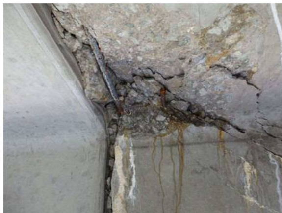
はく落を伴う鉄筋露出（頂版）
