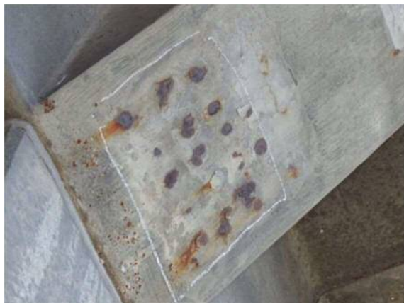
PC 鋼材からの錆汁（主梁）
