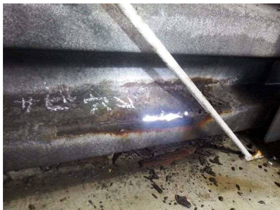
頂版の断面欠損
