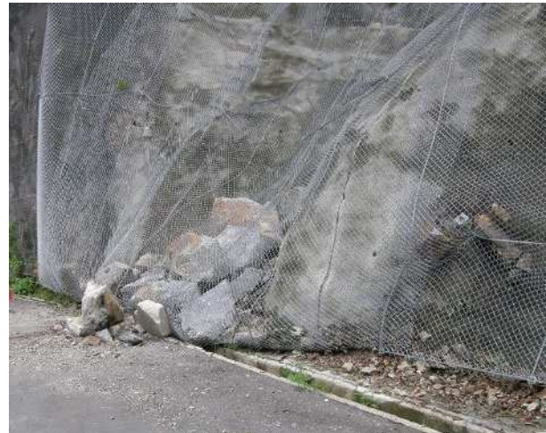
写真 2.20 ネット外への飛散
