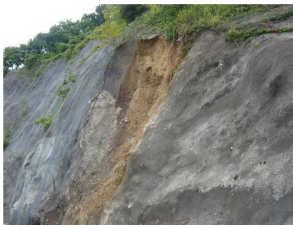
写真 2.1 モルタル吹付の崩壊例
