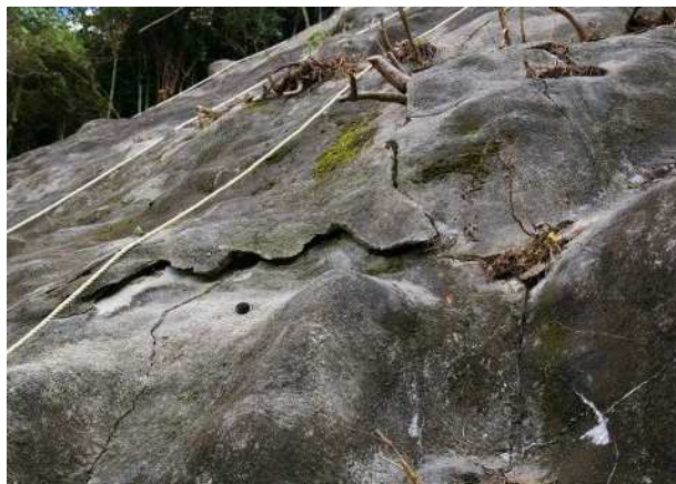
写真 2.2 地山との密着不良に伴う迫り出し
