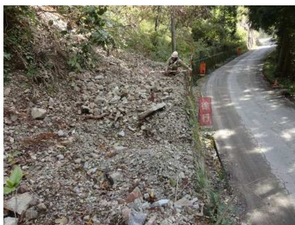
写真 2.30 背面ポケットの土石溢れ
