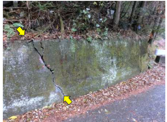
写真 2.21 段差のある開口ひび割れ
