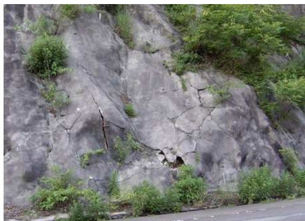
写真 2.4 ひび割れ(全体的・長い・幅大きい例)
