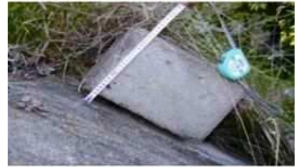
写真 2.32 頭部コンクリートの浮き上がり
