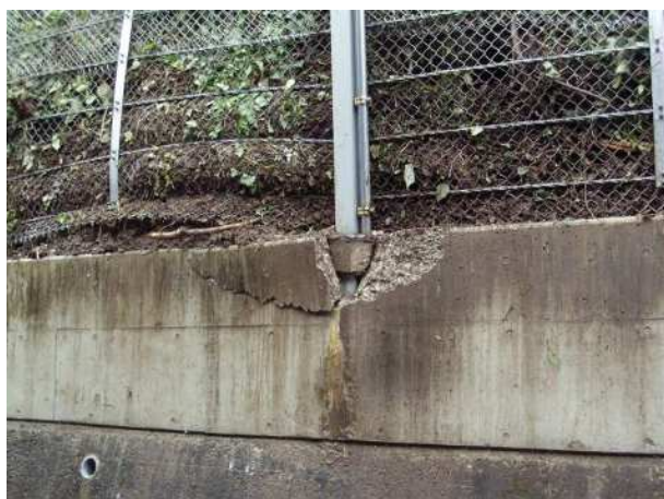
写真 2.28 支柱周りの擁壁割れ
