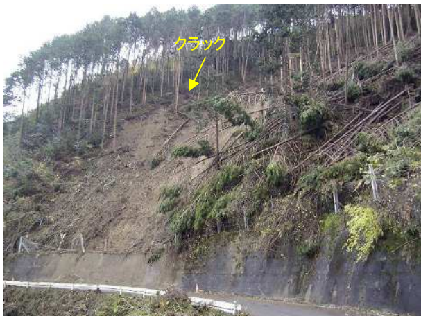
写真 2.8 崩壊斜面のクラック
