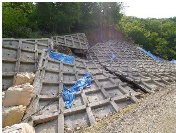
写真 2.11 法枠の崩壊の例
