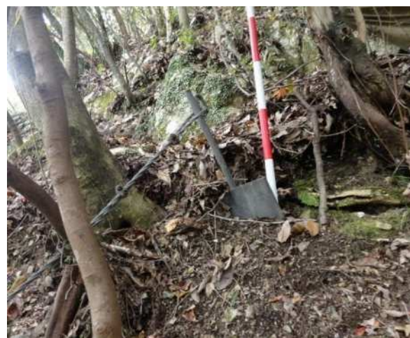
写真 2.18 アンカーの抜け出し
