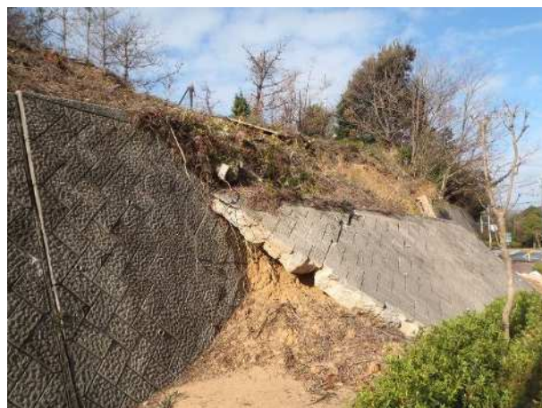
写真 2.24 ブロック積み擁壁の崩壊例
