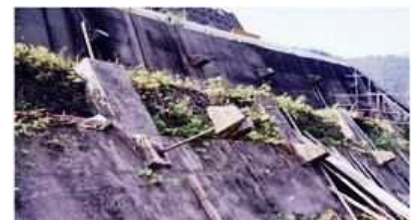
写真 2.35 頭部コンクリートの突出
