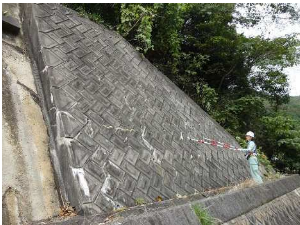
写真 2.25 水平方向に連続するひび割れ
