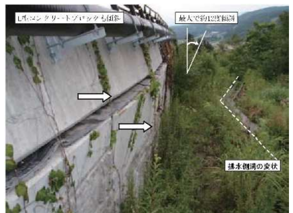
写真 2.22 ※1) テールアルメのはらみだし
