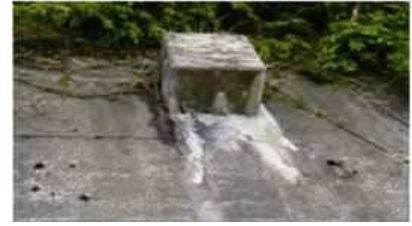
写真 2.33 遊離石灰の流出痕跡
