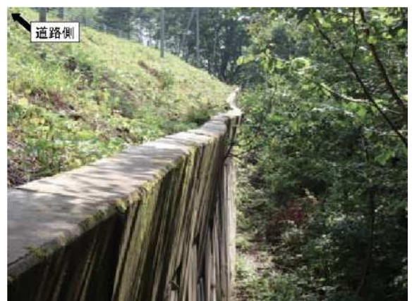
写真 2.23 ※1) テールアルメの傾倒
