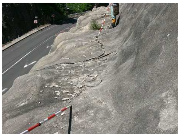
写真 2.6 小段における打音異常箇所の例
