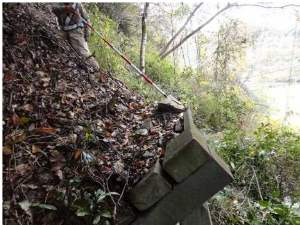
写真 2.31 防止柵背後の土石埋積
