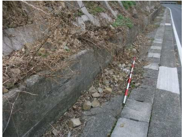
写真 2.15 法枠内にある浮石からの落石
