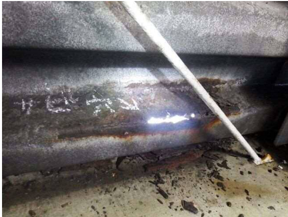
頂版の断面欠損
