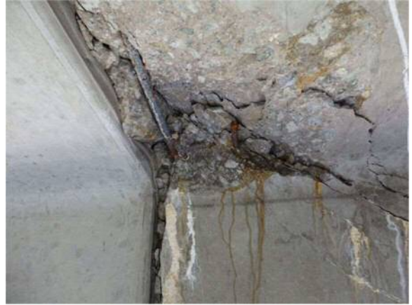
はく落を伴う鉄筋露出（頂版）
