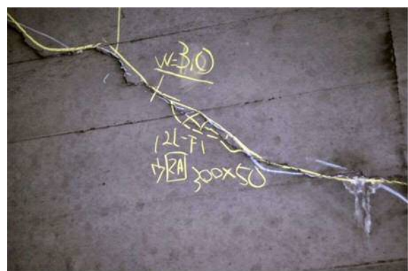
覆工アーチ部のひび割れ
