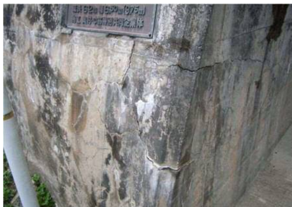
抗門面壁のひび割れ
