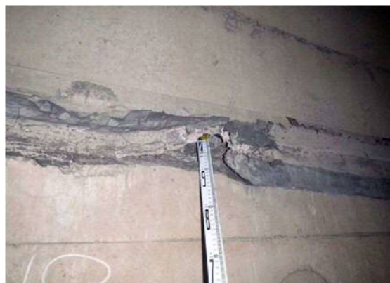
壁面打継部の剥離
