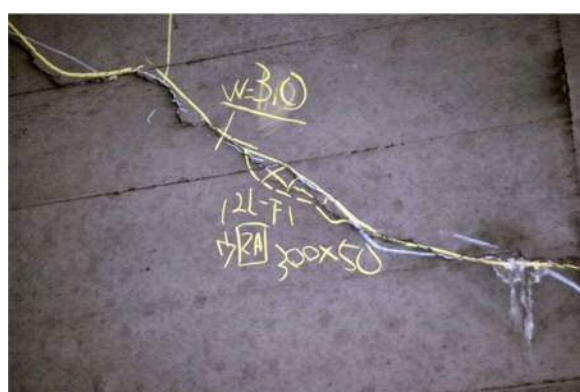
覆工アーチ部のひび割れ
