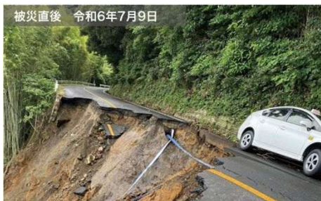
被災状況写真
