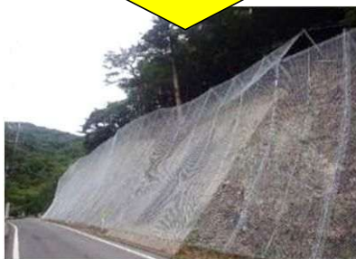
道路への落石防護ネット設置 [西郷都万郡線：隠岐の島町]
