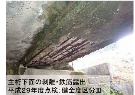
道路橋の損傷事例
