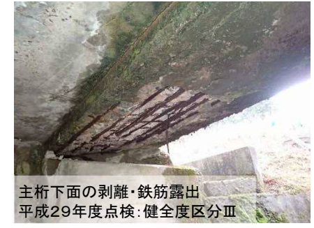
道路橋の損傷事例
