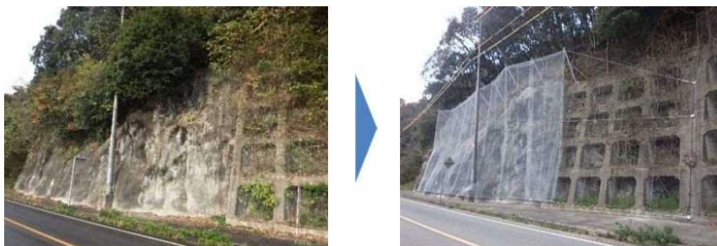
国道261号(邑南町)
