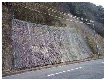
落石防護網 国道187号 (津和野町)
