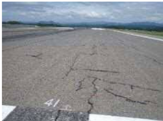
写真一 5 滑走路ひび割れ発生状況
