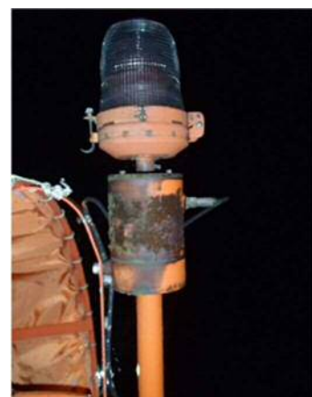
写真一 航空灯火劣化状況
