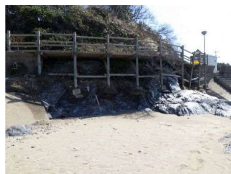
写真－9 侵食による基礎部の露呈
