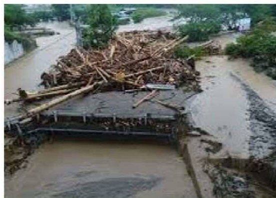
平成 29 年 7 月 九州北部豪雨 大量の流木が橋梁に詰まり氾濫
