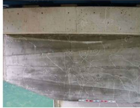
〔橋脚〕 近接目視で容易に視認できるひび割れがあり、顕著な漏水が継続しているなどにより、急速に劣化が進展すると見込まれる
