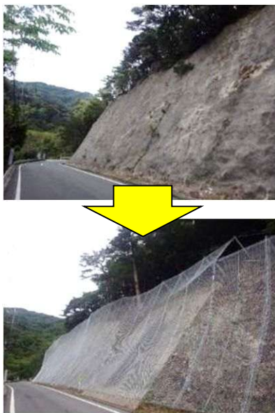
道路への落石防護ネット設置 [西郷都万郡線：隠岐の島町]
