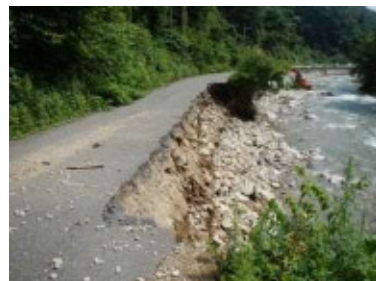
上流域の被災状況
