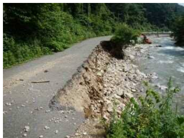
上流域の被災状況
