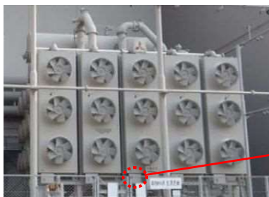
主変圧器（冷却ファン9台） ※縦列3個で1台
