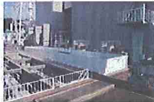
原子炉補機海水ポンプエリアに設置した防水壁
