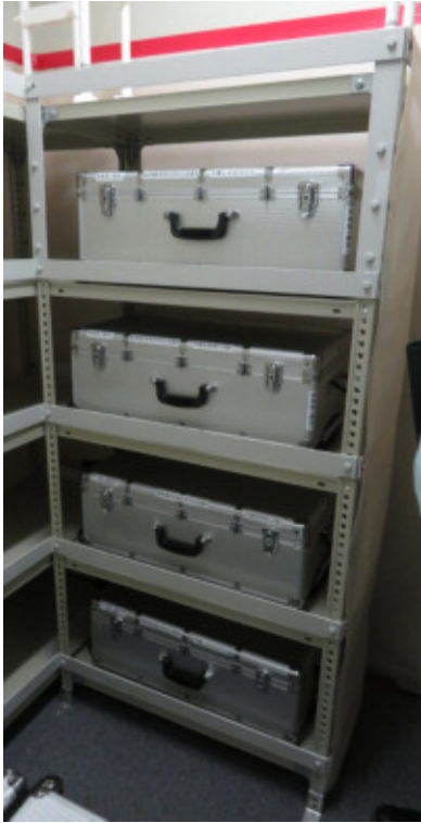
投光器一体型バッテリーの保管状況①
