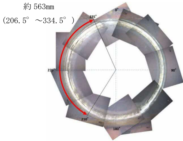
図 4-2 AHC 取付溶接部に発生したひび
