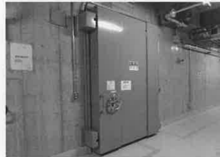
建物内部に設置した水密扉
