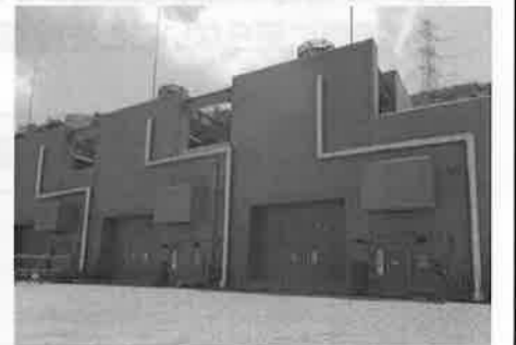
ガスタービン発電機
