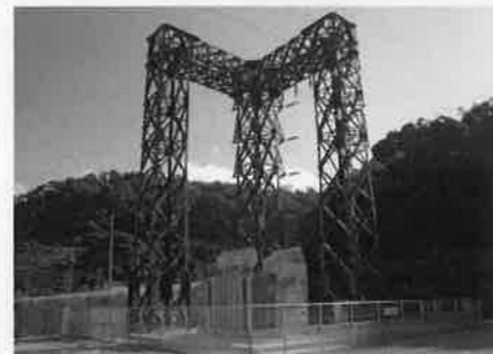
66kV受電設備
