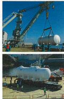
軽油タンク水切・構内輸送状況 (2020年10月20～23日)
