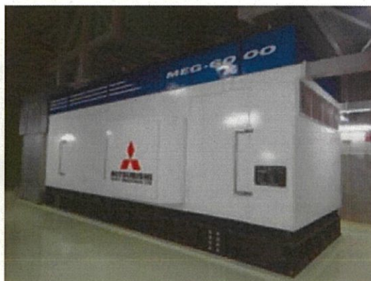
<ガスタービン発電機>
