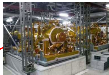
<残留熱代替除去ポンプ外観>
