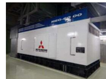
<ガスタービン発電機>
