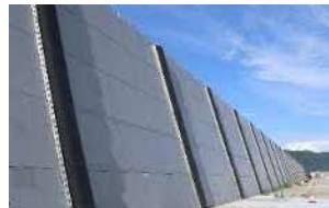
<防波壁(海拔15m、延長1.5km)>
