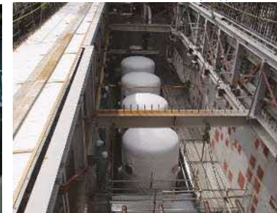
<フィルタ付ベント設備>
