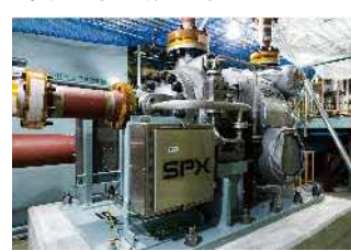
<高圧原子炉代替注水ポンプ>
