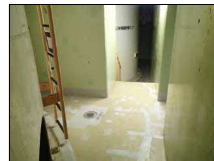
図2 原子炉浄化樹脂貯蔵タンク室
