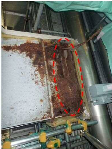
腐食孔 約 100cm×約 30cm
