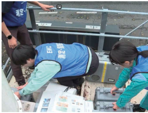
可搬型モニタリングポスト設置
