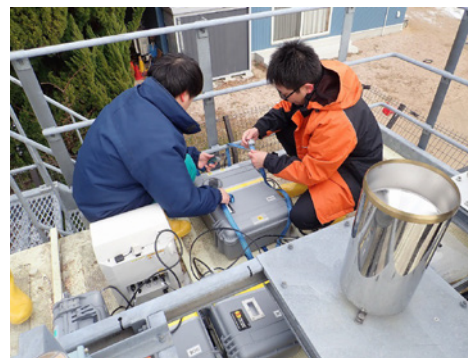
可搬型モニタリングポスト設置
