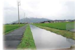
【断面不足の排水路】
