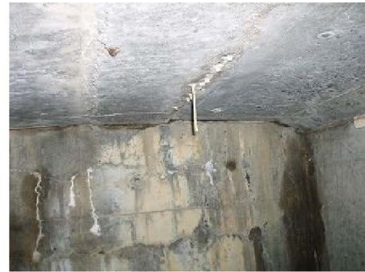
床版のひび割れ・遊離石灰
