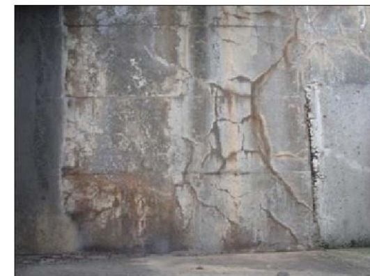
橋台ひび割れ
