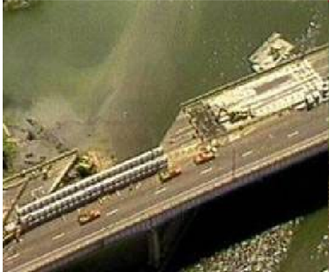
落橋事例2 アメリカマイアナス橋(鋼桁橋)の落橋(1983年)
