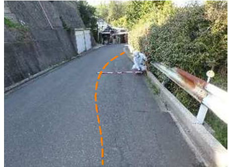
Ph-15 市道の沈下 沈下に伴う亀裂の発達が見られる。
