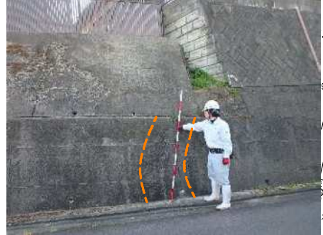
Ph-11 開口亀裂 押し出しに伴う開口亀裂が見られる。
