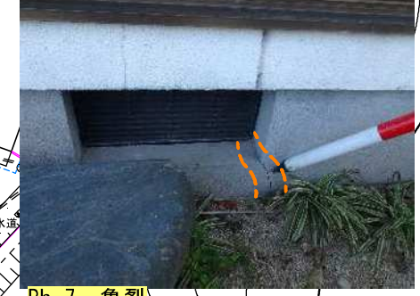
Ph-7 亀裂 家屋基礎に発達する亀裂である。
