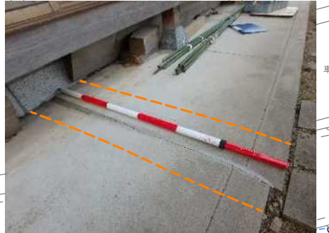
Ph-5 亀裂 犬走りコンクリートにずれが生じている。
