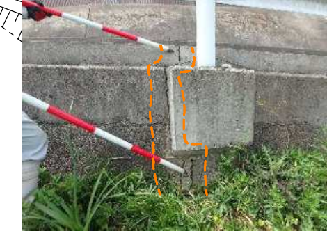
Ph-17 開口亀裂 市道の沈下に伴う亀裂の開口が見られる。
