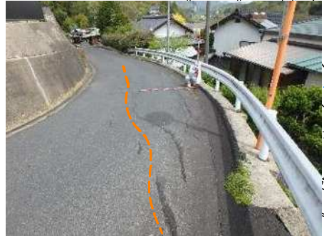
Ph-14 市道の沈下 沈下に伴う亀裂の発達が見られる。
