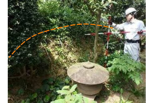
Ph-16 崩壊跡 土塊の押し出しに伴う崩壊跡である。
