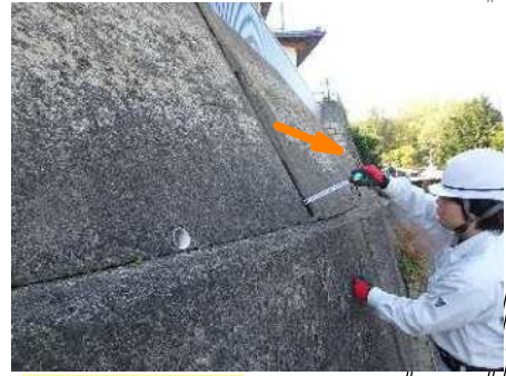
Ph-10 押し出し 3cm程度の張コンの押し出しが見られる。
