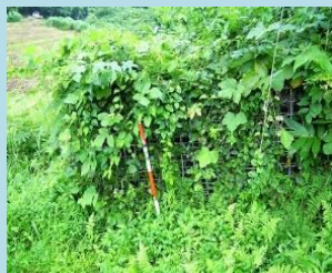
維持管理を実施していない防護柵
