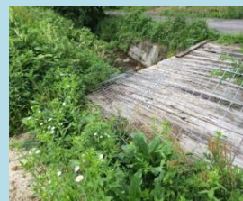
雑草の繁茂により倒れた柵
