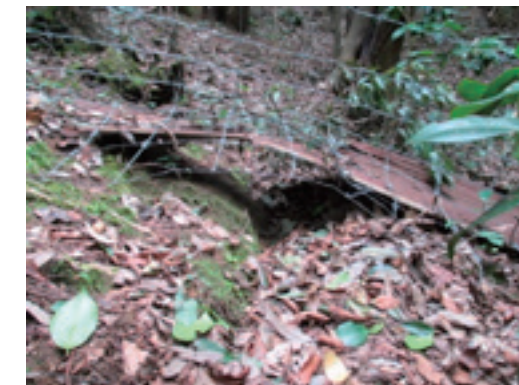
写真6 下部の隙間 (A 地区)
