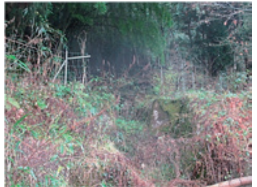
写真16 柵で塞ぎきれていない水路 (C地区)
