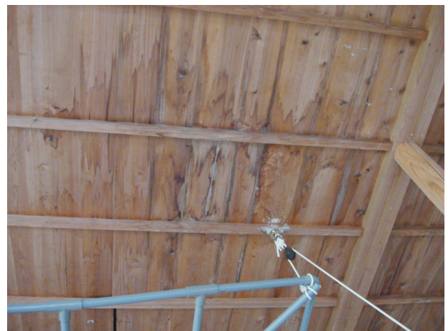
写真5 天井の糞尿による汚れ（川本町の神社）
