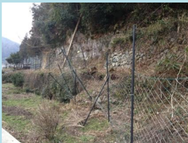
写真1 匹見集落の山際に設置された管理が不十分な電気柵（左：ネットが破損、右：雪で支柱が倒伏）
