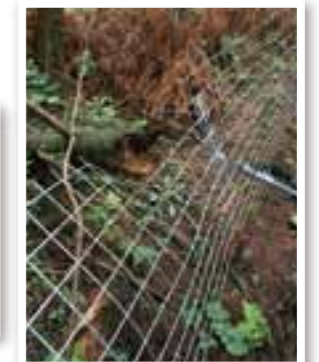
倒木による柵の破損
