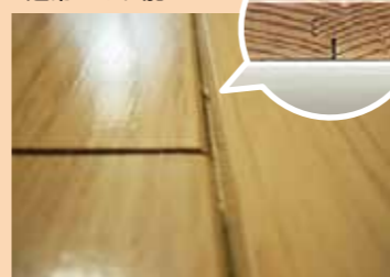
通常のフローリング 隙間が空いている様子
