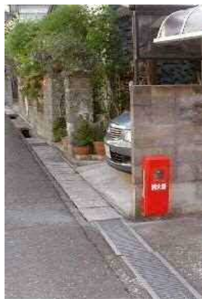
町内15カ所に屋外消火器設置
