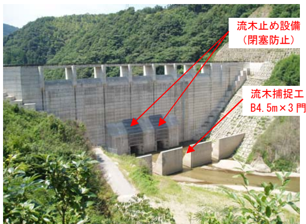
写真-1 流木止め設備 (ダム上流面)
