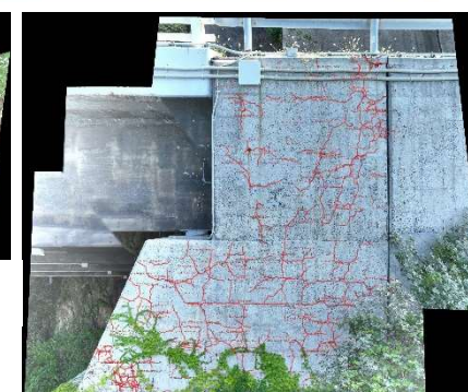
【橋台ひび割れ状況】
