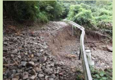
道路決壊・土砂流出
