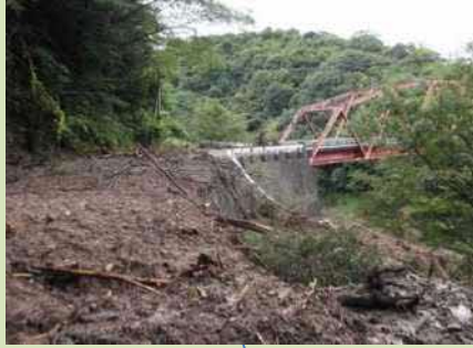
路肩決壊・土砂流出
