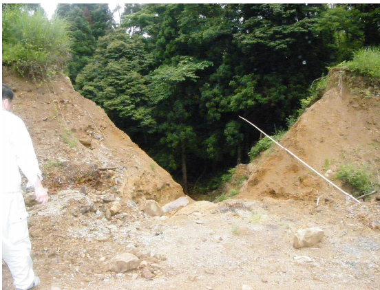
堤体被災状況
