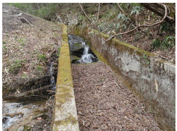
余水吐被災状況
