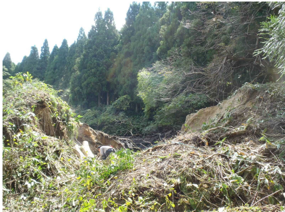
堤体被災状況
