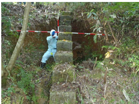
斜樋廻り浸食状況
