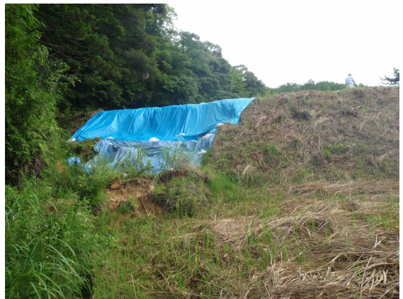
堤体被災状況
